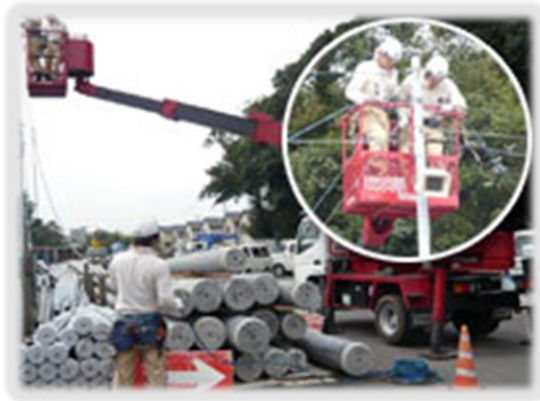
❖ 光ファイバーケーブルの高所布設 高所作業車にて光ケーブルの張りこみ
